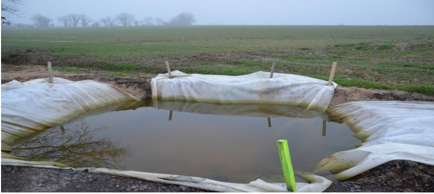
bassin de filtration des eaux de pompage qui déborde dans les angles
